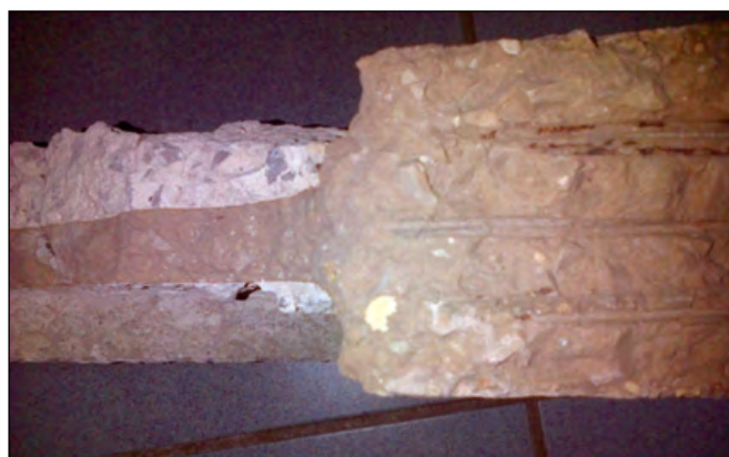
Foto vigueta con dos hormigones: la vigueta está fabricada con cemento aluminoso y los restos de hormigón pegados al lateral son de cemento portland.
